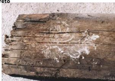
Fungos destruidores de madeira
