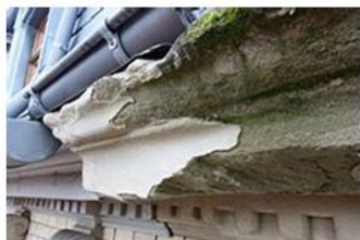
Utilização do material incorreto
