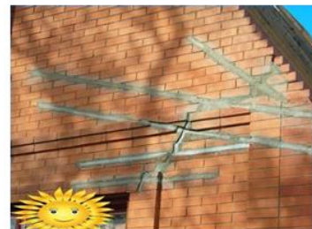
Fissura numa parede de tijolo recentemente construída
