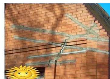
Grieta en pared de ladrillo recién construida
