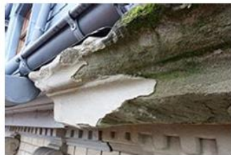
Material incorrecto utilizado
